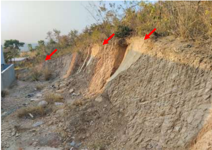
Figura 5 – Indicação da Erosão Superficial e Distribuição da Vegetação no Talude Analisado.
