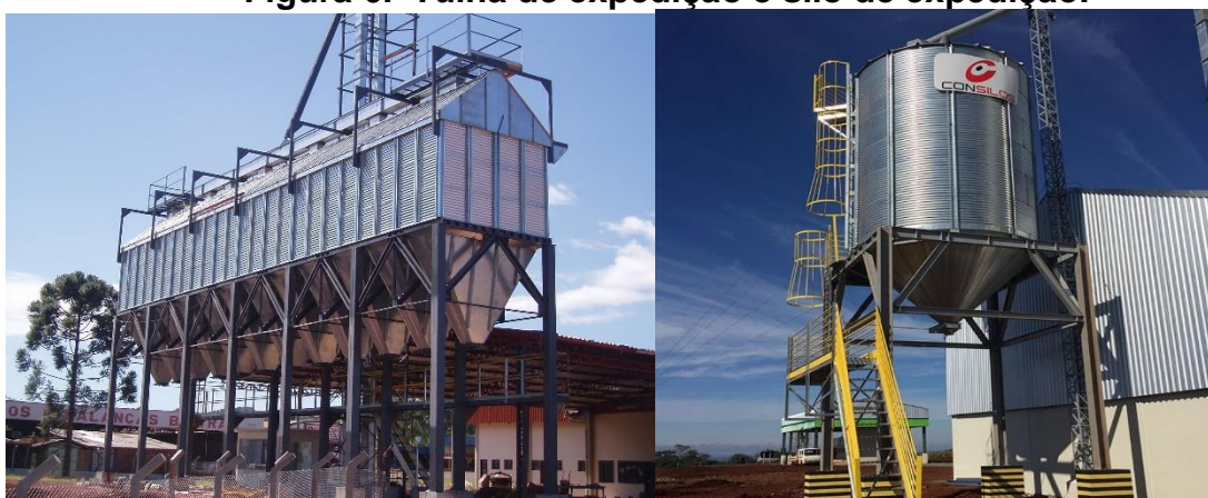
Figura 6. Tulha de expedição e silo de expedição.
