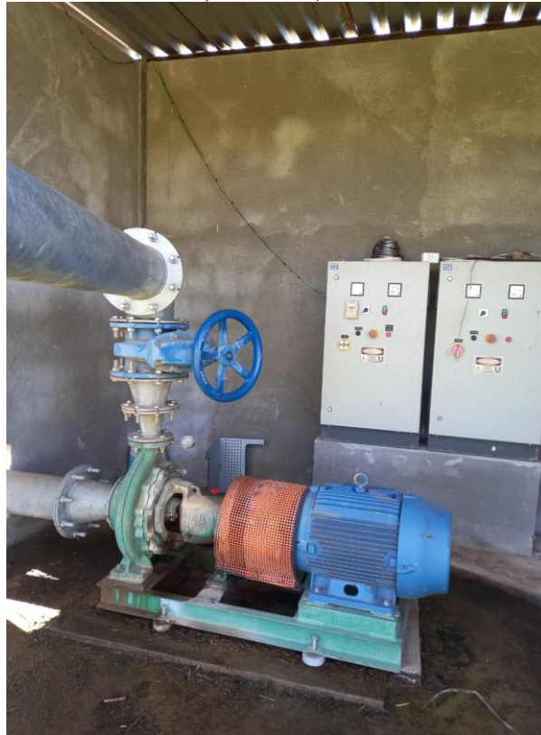
Figura 3 - Sistema de bombeamento para irrigação por pivô central (equipamento implantado na Fazenda Galho, Unai-MG).
