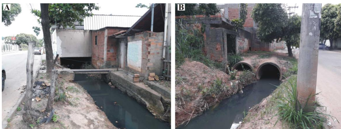
Figura 8 – Aspecto do leito do Rio São Jacinto na área urbana de Teófilo Otoni (MG). Observe que passarelas rudimentares de madeira ligam a rua às residências, bem como há residências construídas sobre o canal (A). A canalização do rio está, em alguns trechos, parcialmente comprometida pelo entulhamento por sedimentos e lixo (B).
