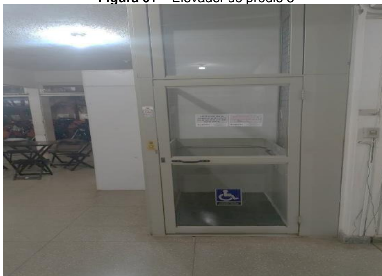
Figura 01 – Elevador do prédio 3
